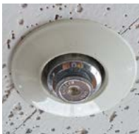
スプリンクラー設備
