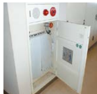
屋内消火栓設備
