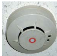
自動火災報知設備
