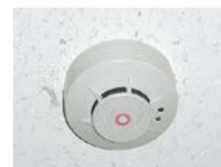
自動火災報知設備
