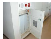
屋内消火栓設備
