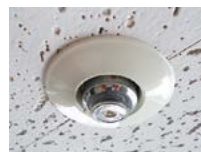
スプリンクラー設備
