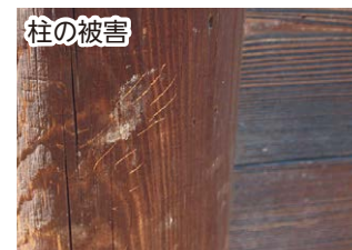
柱の被害 柱に登ったことで付く爪痕
