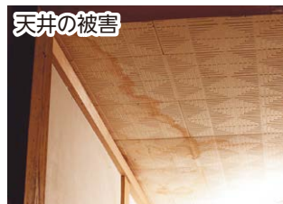
天井の被害 屋根裏にすみ付いたことによるふん尿のシミ
