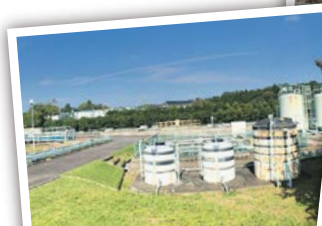
豊が丘団地の共同汚水処理施設
