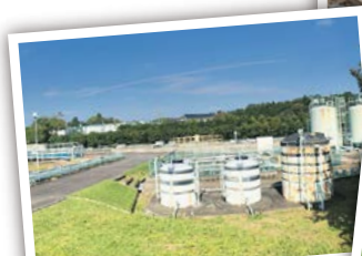
豊が丘団地の共同汚水処理施設
