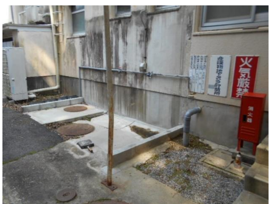
浴場用地下タンク
