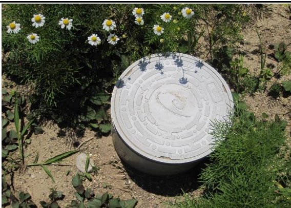
5 公共下水道汚水枡
