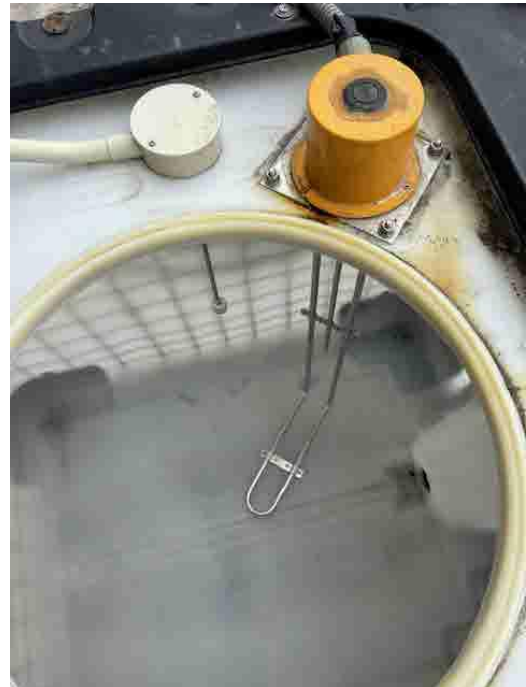
ヒーター (槽内部)
